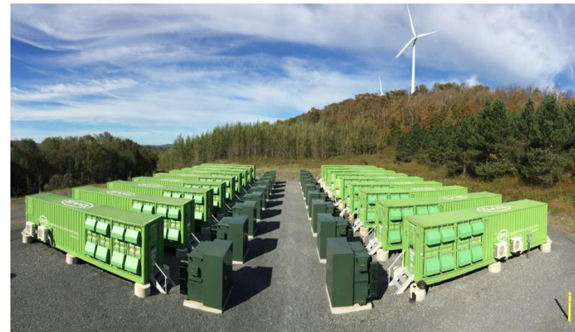
Integração Solar PV & ESS
