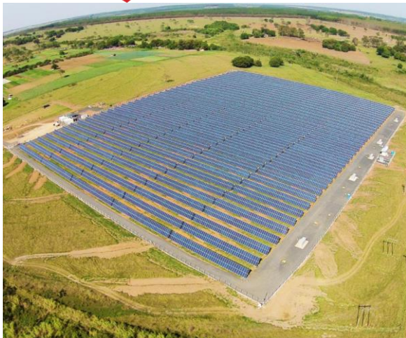
Módulos Fotovoltaicos (GC e GD)
