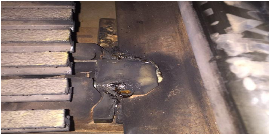
Figura 6 – Placa de fixação do trilho avariada
