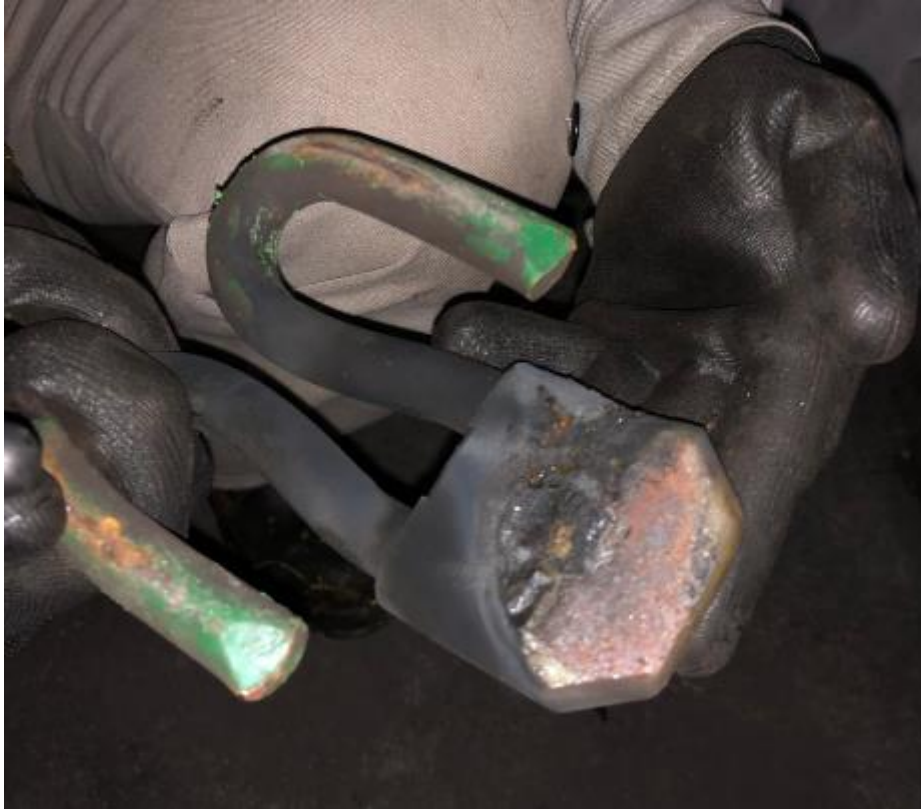
Figura 14 – Equipamento danificado pela corrente de fuga
