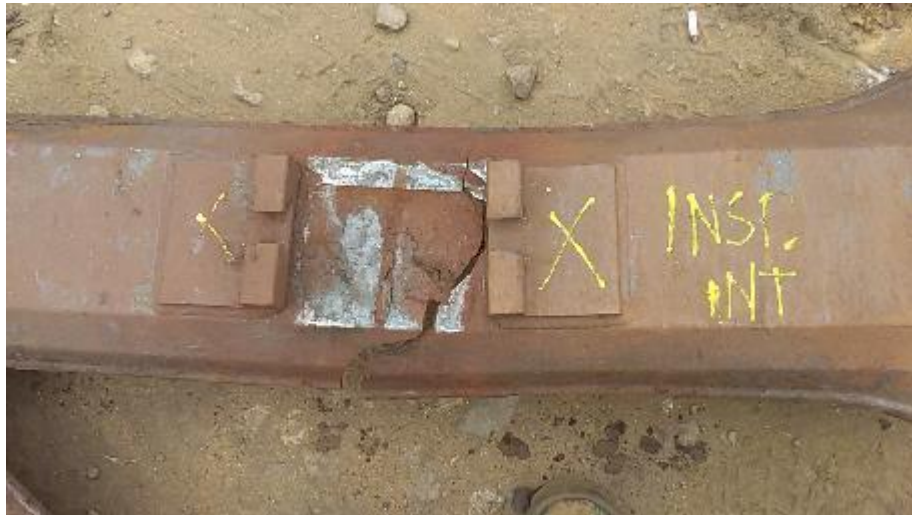
Figura 3 - Dormente de aço quebrado típico. Ano de Fabricação 2007.
