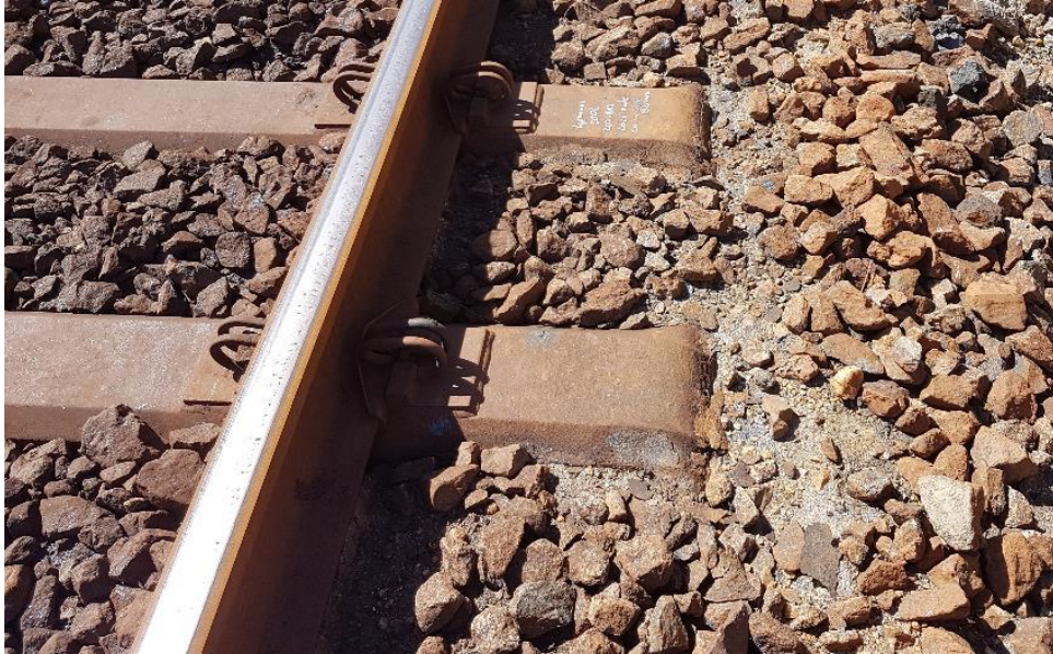
Figura 9 – Imagem demonstrando situação típica do dormente de aço embebido no lastro contaminado por minério, solo e outras substâncias.
