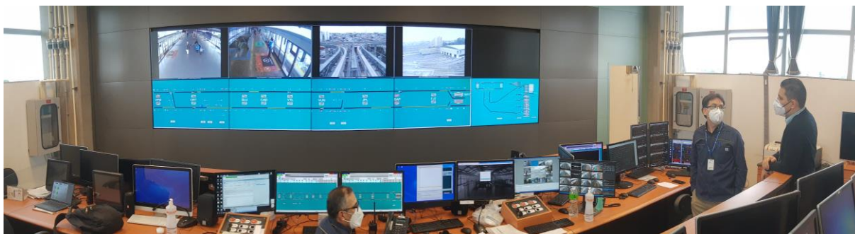
Figura-2 Visão geral do CC15- CCO do monotrilho operado pelo Metrô-SP Fonte: Arquivo pessoal dos autores, 2020.
