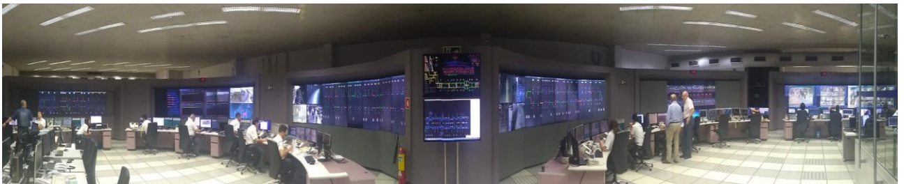
Figura-1 Visão panorâmica da Sala de Controle do CCO do Metrô-SP Fonte: Arquivo pessoal dos autores, 2020.
